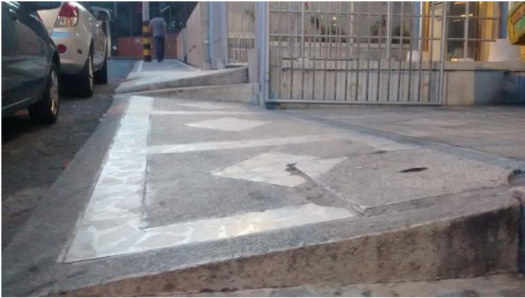
Fig. 8 Falta de continuidad en el andén. Propiedad del autor (2017)
