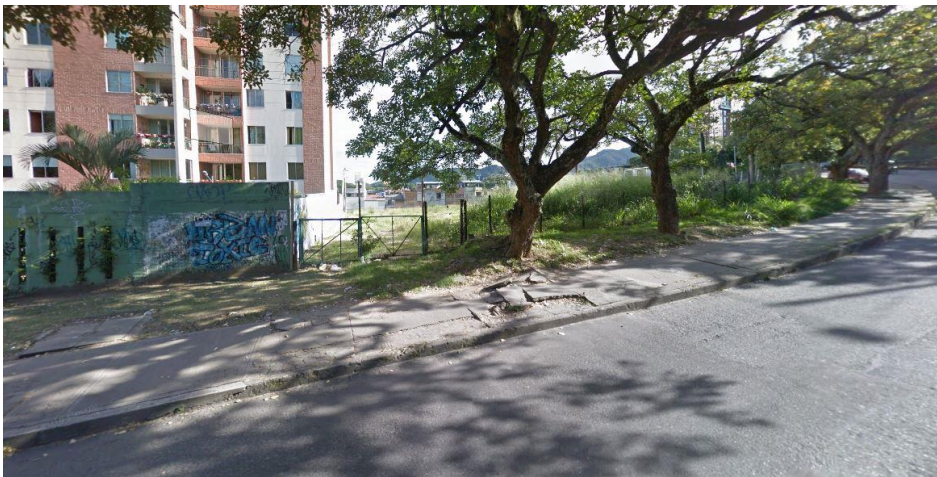
Fig. 4 Deterioro de franja de circulación peatonal. Tomado de Google Maps (2016)
