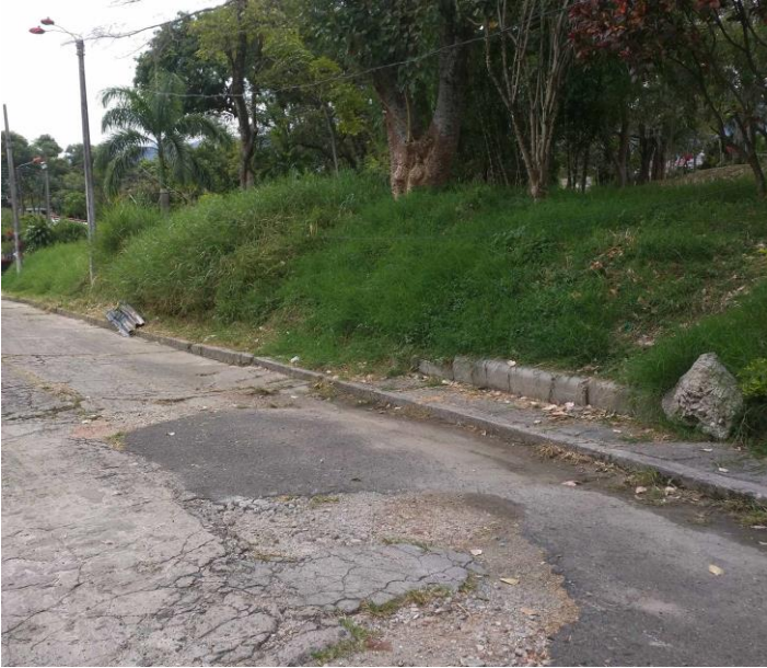
Figura 5. Deterioro de las vías alrededor del caño.
