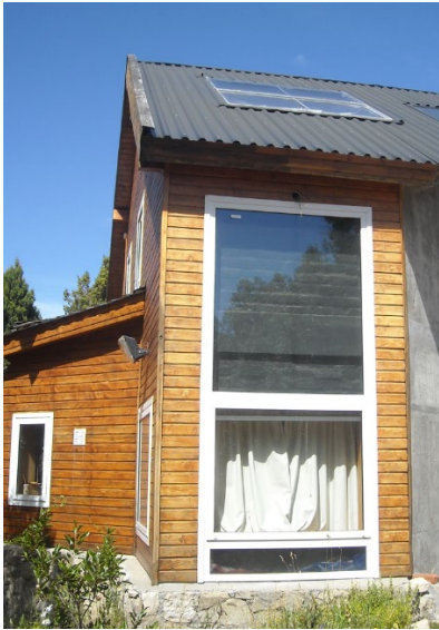
Figura 6. Ventana para lograr ganancia directa y muro acumulador. Colectores solares para calentamiento de agua integrados en el techo.
